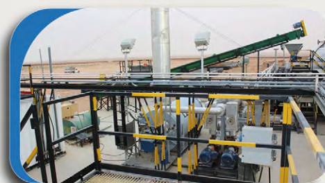
Thermal Desorption Unit
